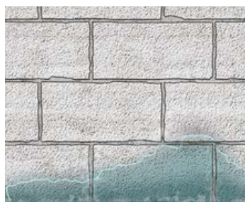
Atención de humedades
